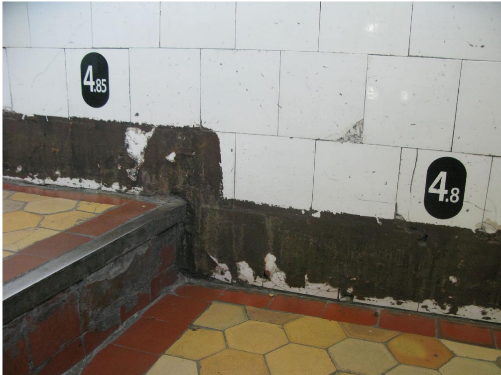
vues de l'installation
